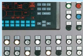
SPS für die automatische Steuerung.
